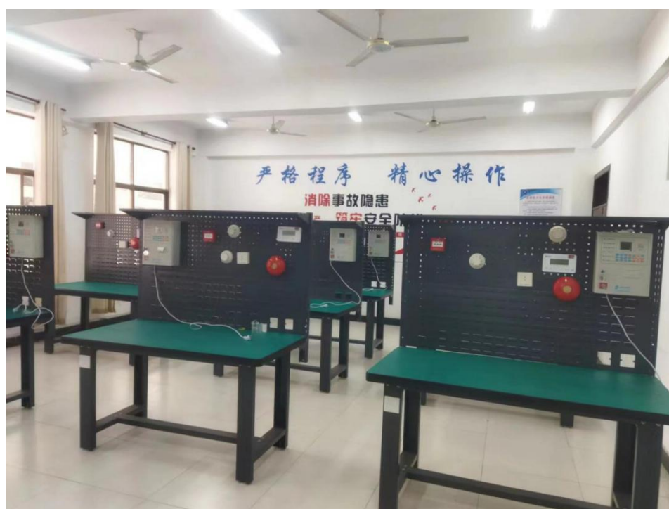
图 2-12 消防控制中心实训室
